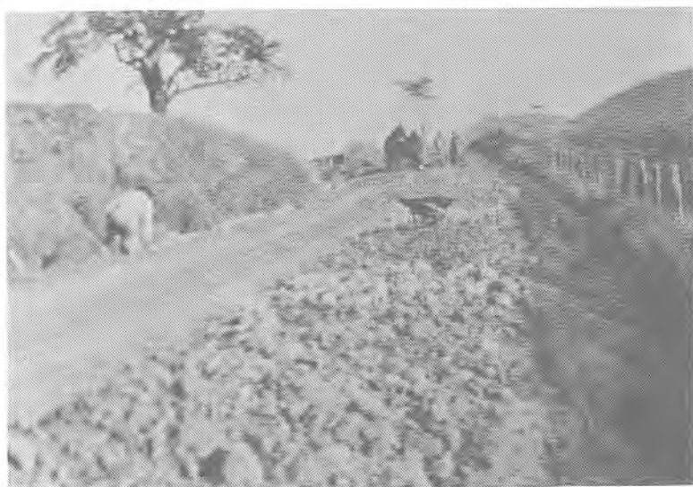
Travaux de voirie sur le chemin Jeannotte, vers 1920. Au fond, à droite, le Mont Saint-Hilaire. (Collection F. Authier).
